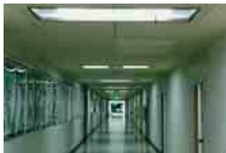
写真2 学科2階廊下に導入された直管型LED照明
