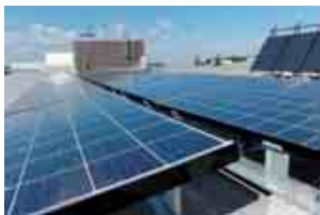
写真1 電気電子システム専門棟屋上に設置された太陽電池
