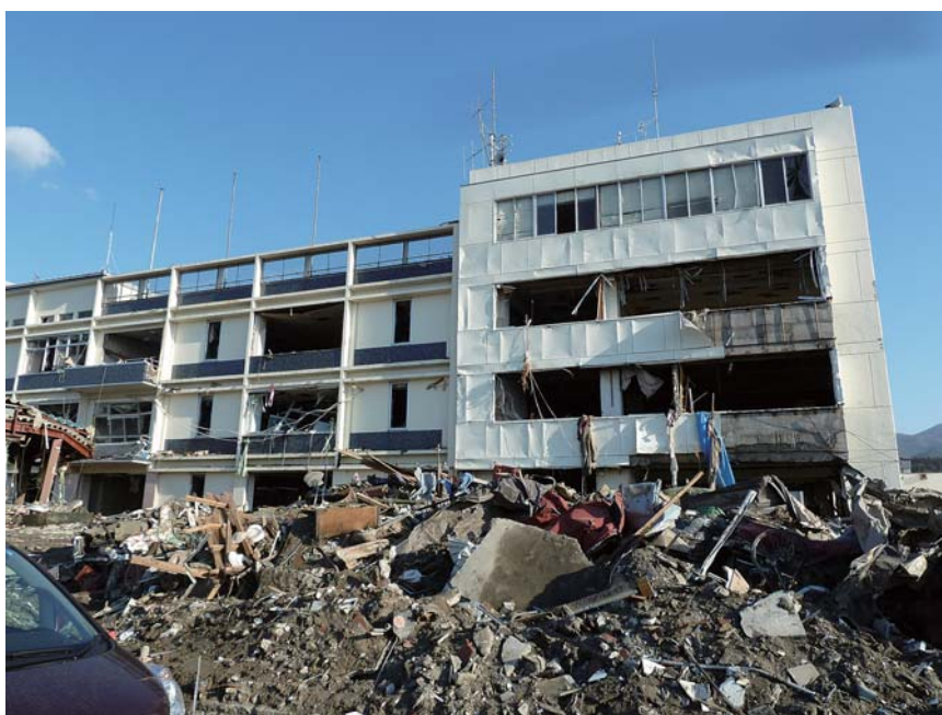
被災した建物
