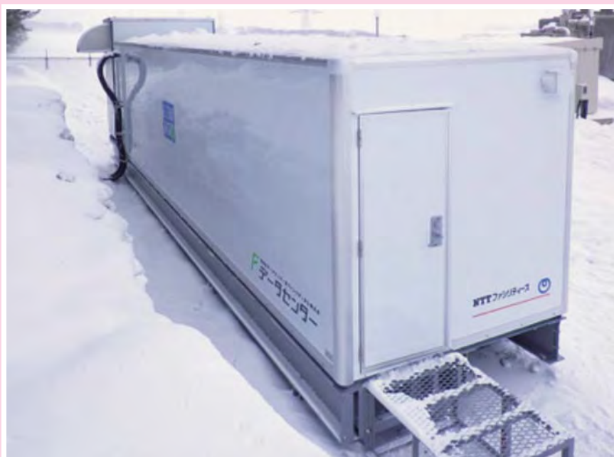
むつ小川原グリーンIT推進協議会による実証実験用コンテナ型データセンター (2012.1.31 ~ 2013.3.31 実験運用)
