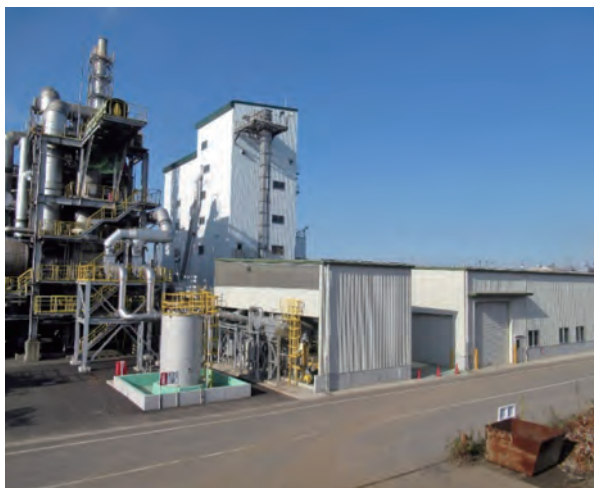
低濃度 PCB 無害化処理施設（全景）
