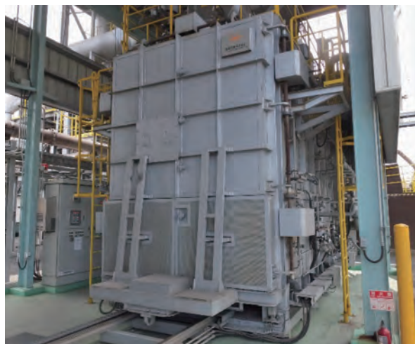
低濃度 PCB 無害化処理施設（固定床炉）
